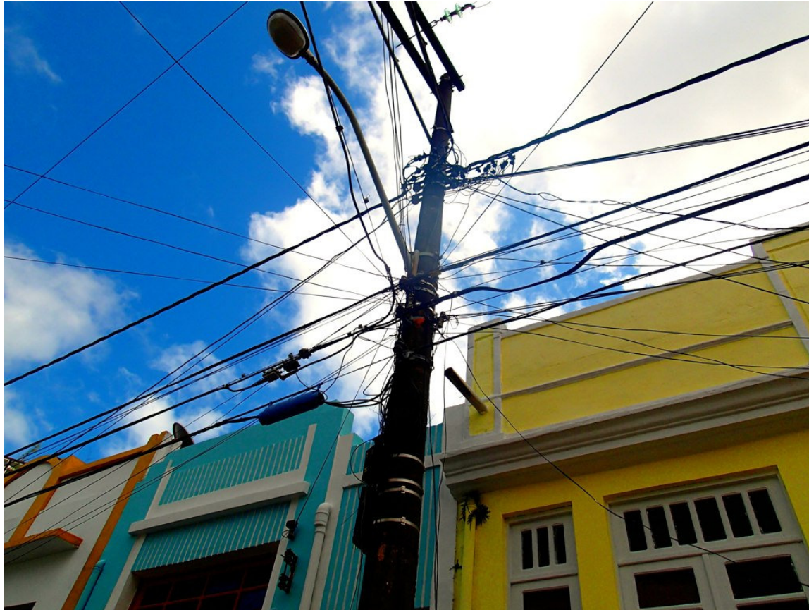
Un câble électrique
